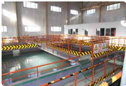
尾矿压滤干排回水系统
